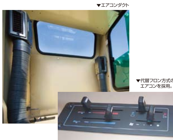
▼エアコンダクト
